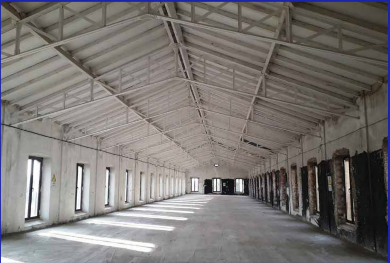
Cubiertas de las salas de la planta primera. Foto Laura Hernández Alcaraz
